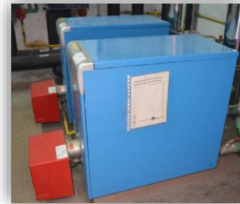
Sala de calderas de propano preexistentes
