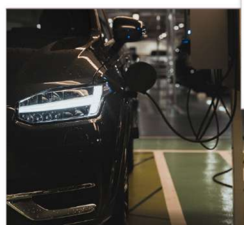
Infraestructura de recarga de vehículos eléctricos
